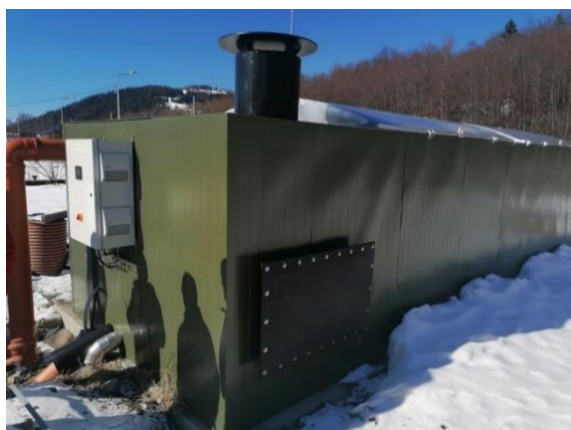
Fot. 3 Stacja dezodoryzacji
